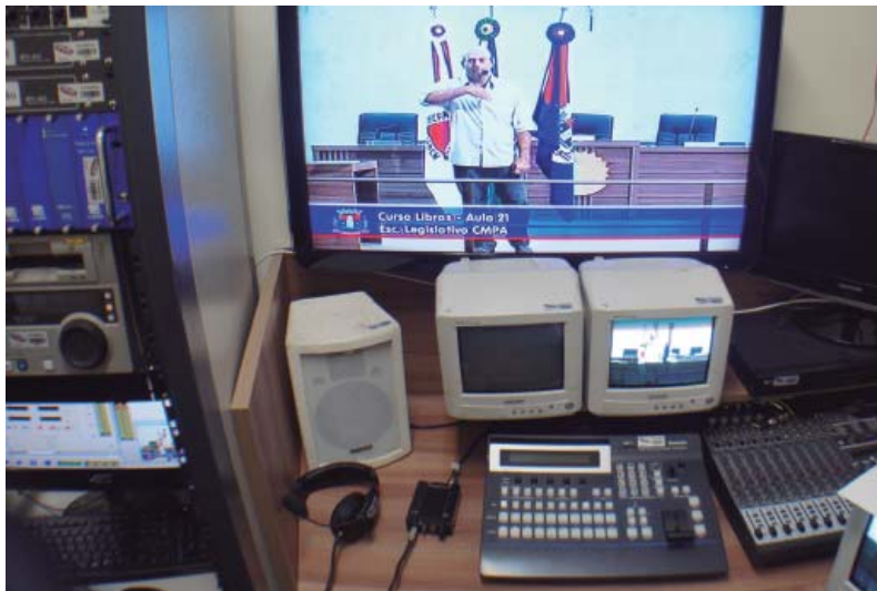
Switcher e mesa de corte da transmissão do Plenário da Câmara Municipal: grade variada
